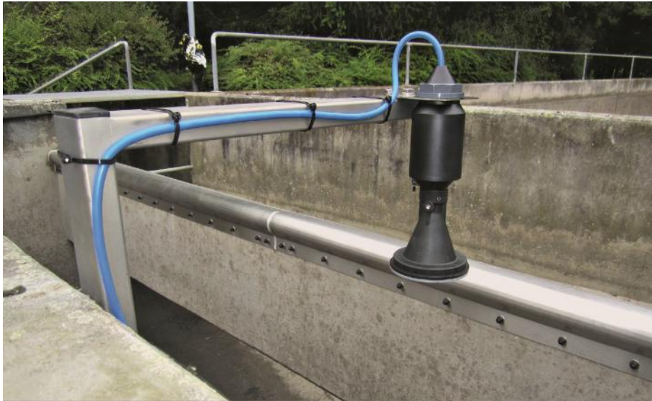
Abb. 18: Radarsonde vor einem Überlauf mit speziellem Messprofil
