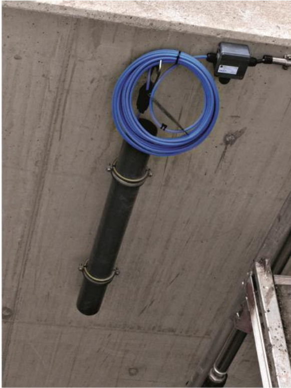
Abb. 8: Tauchsonde mit Hüllrohr an einem Regenüberlaufbecken
