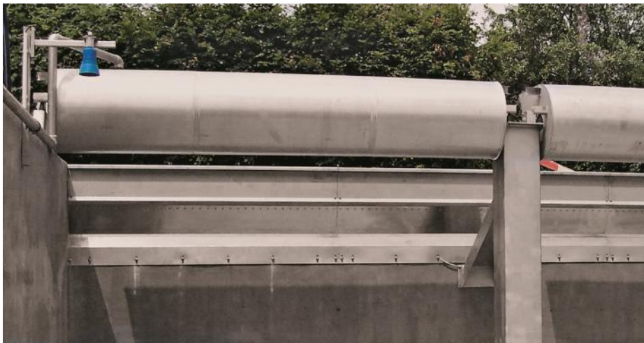
Abb. 11: Ultraschallschallkeule (links) an einem offenen Becken zur Ansteuerung von Spülkippen zur Reinigung des Bauwerkes nach Entleerung
