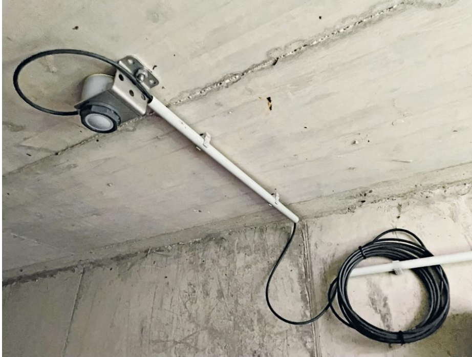
Abb. 14: Kompakte Radar- sonde, nur wenige Zentimeter unter der Beckendecke montiert
