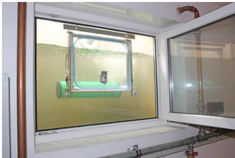
Abb. 79: Geflutetes Kellerfenster mit automatisch schließender Scheibe
