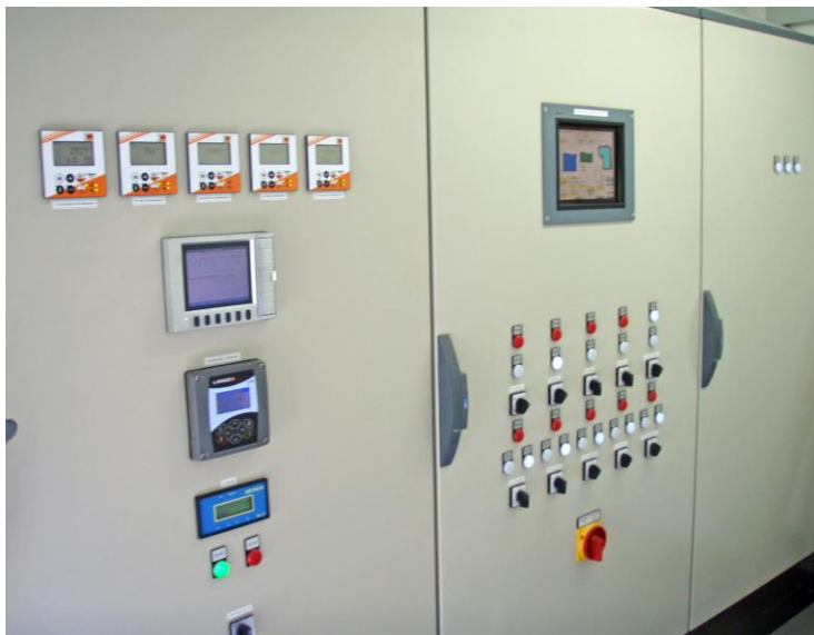
Abb. 87: Leittechnik einer Wasserversorgungsanlage
