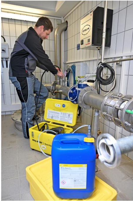
Abb. 96: Inbetriebnahme eines mobilen Systems zur Notchlorung (Desinfektion)
