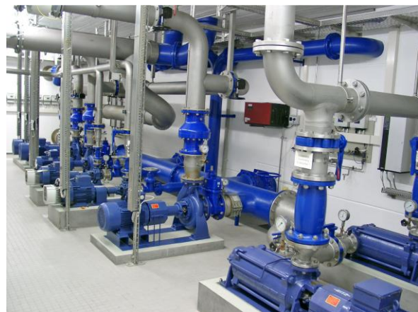
Abb. 34: Pumpanlage eines Wasserwerks mit mehreren redundanten Pumpen
