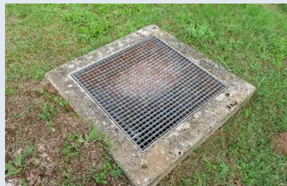
KA Holnstein – Absturzgefahr z. B. für Amphibien
