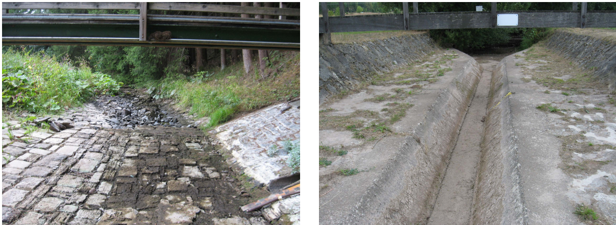
Abb. 17: Trockengefallene Pegelmessstellen im Frankenwald Geschwend/Kremnitz [Einzugsgebiet 46,2 km 2 ] (links) und Friedersdorf/Buchbach (rechts) [Einzugsgebiet 11,1 km 2 ] im August 2018
