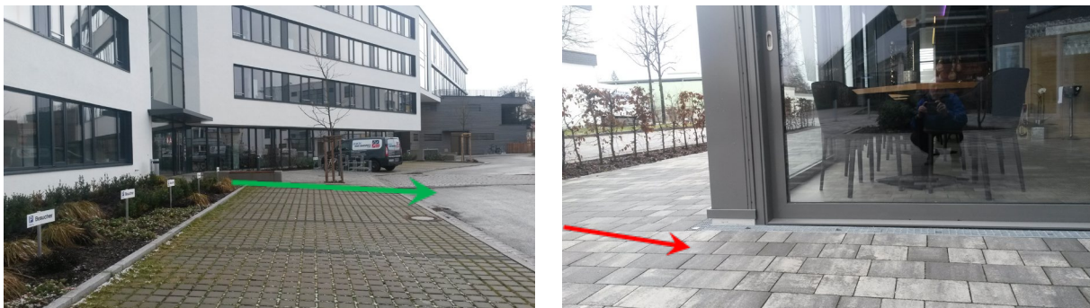
Abb. 6-5: Das umliegende Gelände sollte so gestaltet werden, dass Niederschlagswasser vom Gebäude wegfließen kann (links). Ein Gebäude, dessen Erdgeschoss unter dem Straßenniveau liegt, ist bei Starkregen besonders gefährdet.
