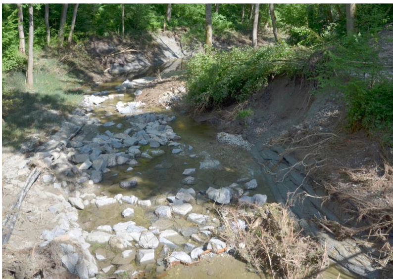
Abb. 3-27: Antersdorfer Bach (Höhe Brücke nach Hinterholz) am 7. Juni 2016
