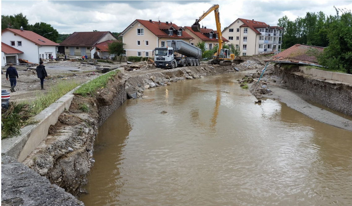
Abb. 3-26: Schäden an den Hochwasserschutzanlagen in Simbach am Inn
