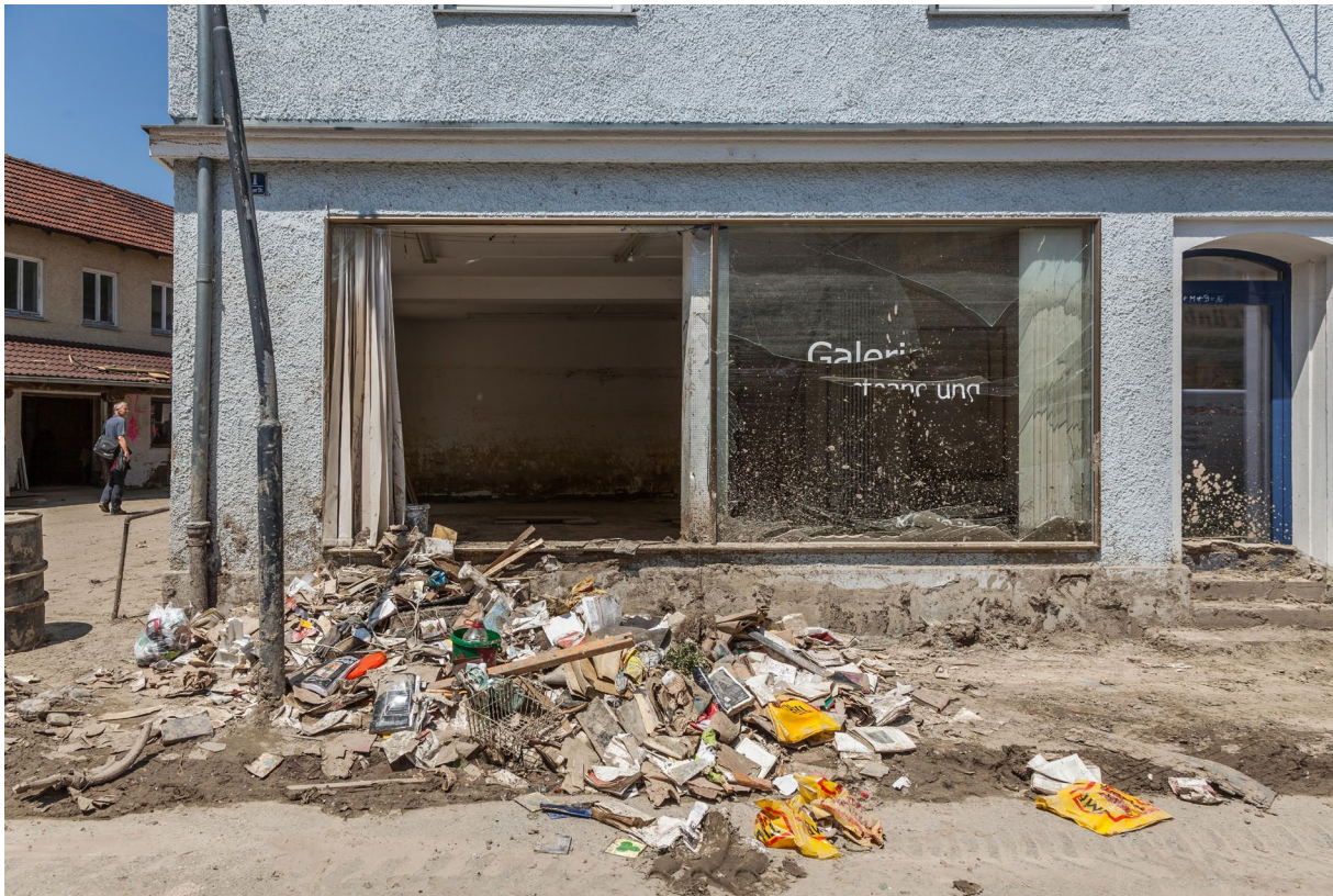
Abb. 3-18: Schäden an einem Ladengeschäft in Simbach am Inn
