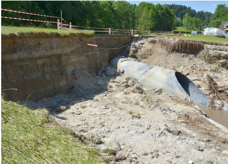
Abb. 3-12: Erodierter Straßendamm in Simbach am Inn
