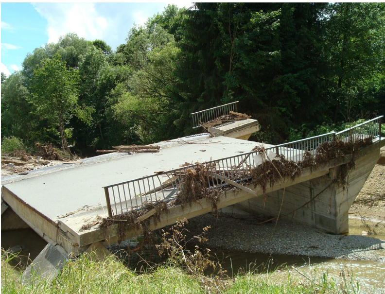
Abb. 3-22: Völlig zerstörtes Brückenbauwerk am Tanner Bach, Landkreis Rottal-Inn
