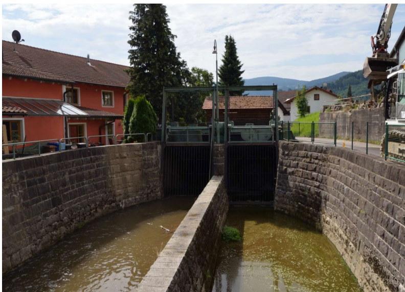
Abb. 3-4: Einlaufbereich in die Verrohrung des Eckerbachs in Oberzell. Bis zur Mündung in die Donau verläuft der Eckerbach auf einer Länge von circa 400 Metern in einer Verrohrung durch den Ortsbereich.
