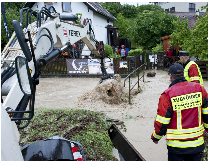
Abb. 3-16: Am Wörtersbach in Peißenberg versucht die Feuerwehr mit einem Bagger die Verklausung an einer Brücke während dem Ereignis am 29. Mai 2016 zu entfernen.
