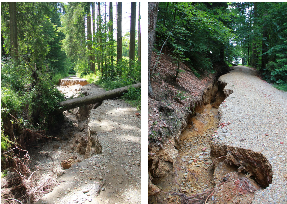
Abb. 3-29: Zerstörte Forst- und Wanderwege bei Oberjulbach (Gemeinde Julbach, links) und Straß (Gemeinde Simbach am Inn, rechts) durch wild abfließendes Wasser
