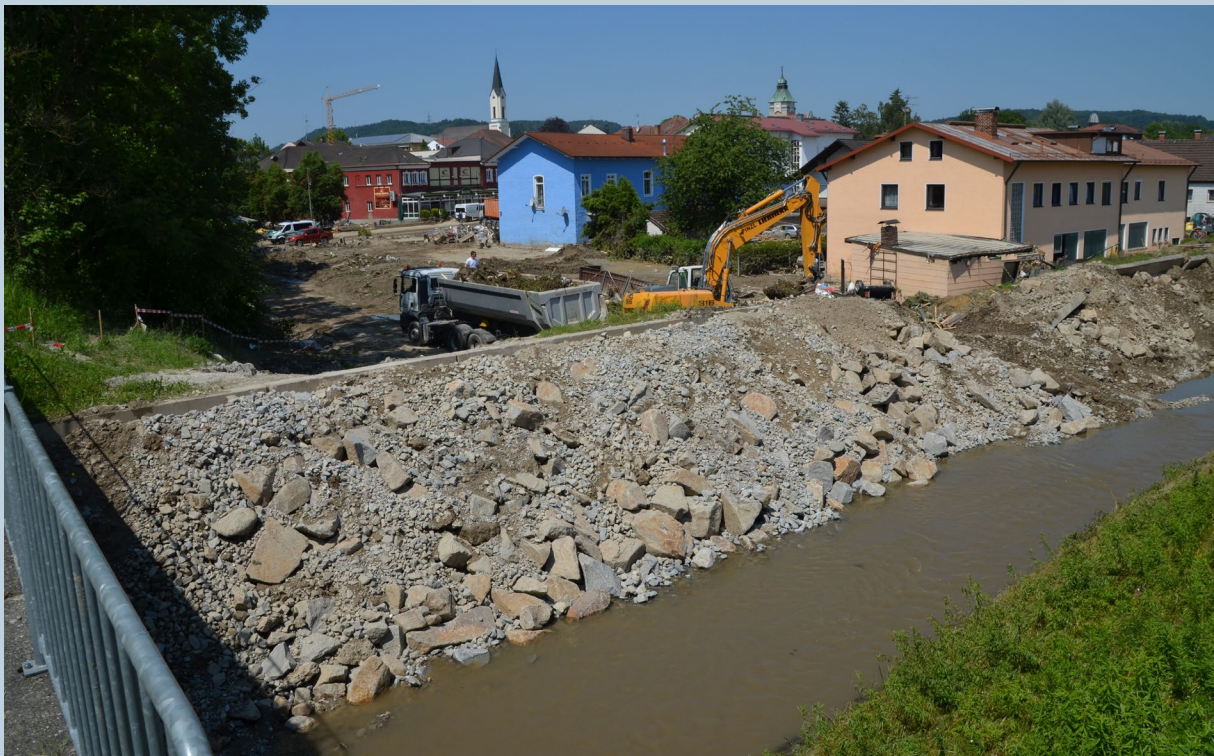
Abb. 4-21: Der beim Ereignis überströmte orografisch rechte (westliche) Deich am 7. Juni 2016 (Blick gegen Fließrichtung)
