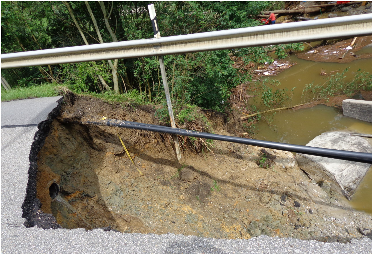
Abb. 3-25: Abgerissene Abwasserhauptleitung vor der Kläranlage, Gemeinde Wittibreit im Landkreis Rottal-Inn
