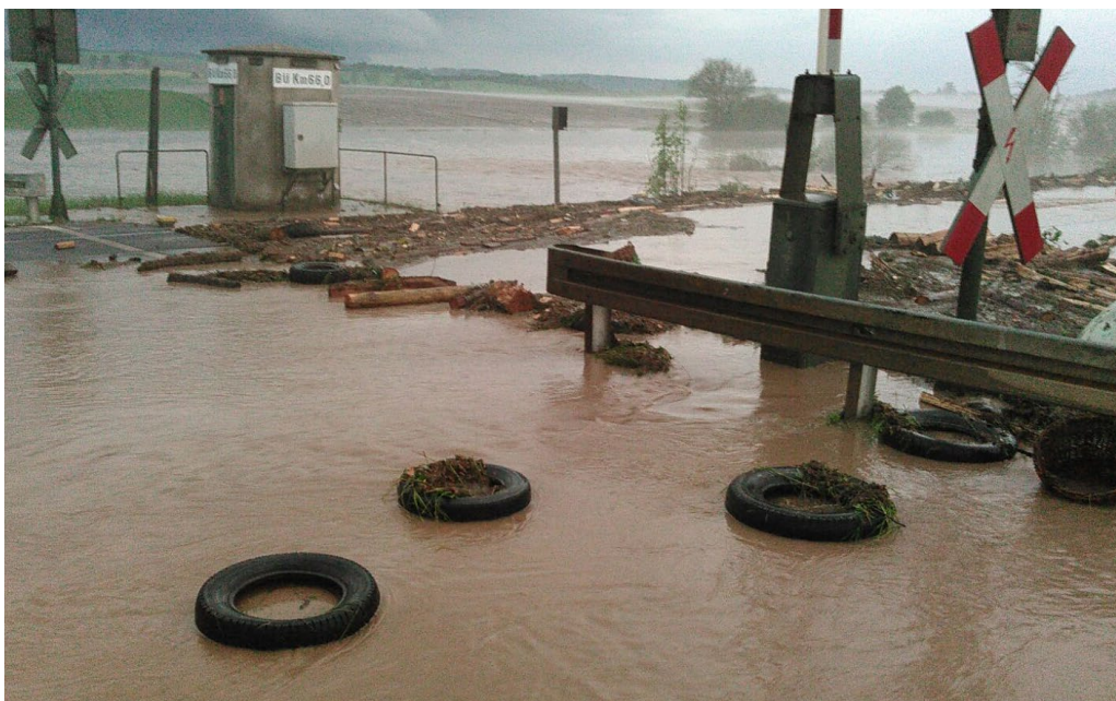
Abb. 3-24: Überschwemmte Gleisanlage an einem Bahnübergang der Bahnlinie Ansbach – Würzburg
