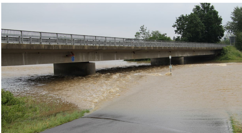
Abb. 5-3: Flutmulde unter der Brücke der B388 – ohne Wasser (oben) und gefüllt beim Ereignis 2016 (unten), Markt Ruhstorf, Landkreis Passau
