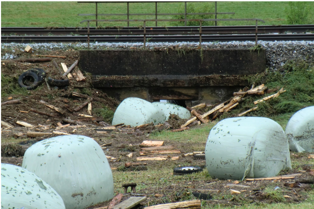
Abb. 3-14: Mit Silageballen und Brennholz verstopfter Durchlass unter der Bahnlinie zwischen Ansbach und Würzburg bei Oberdachstetten (Landkreis Ansbach).
