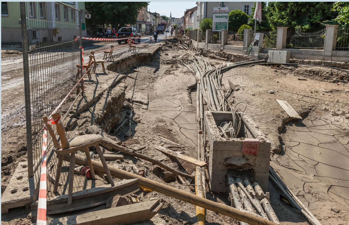
Abb. 4-18: Die Innstraße ist nach dem Ereignis großteils nicht mehr befahrbar. Versorgungsleitungen liegen frei.
