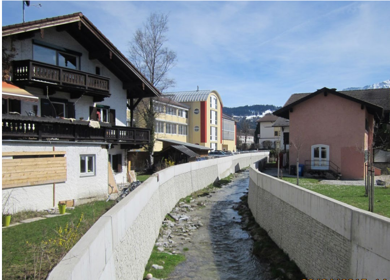
Abb. 3-3: Gerinne der Kanker in Garmisch-Partenkirchen. Die bis dicht an den Gewässerlauf heranreichende Bebauung, lässt nur noch ein schmales Betonschussgerinne zu. Im nicht auszuschließenden Überlastfall sind Schäden vorprogrammiert.
