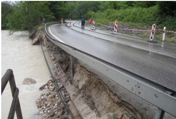
Abb. 5-4: Uferschaden an der B 305
