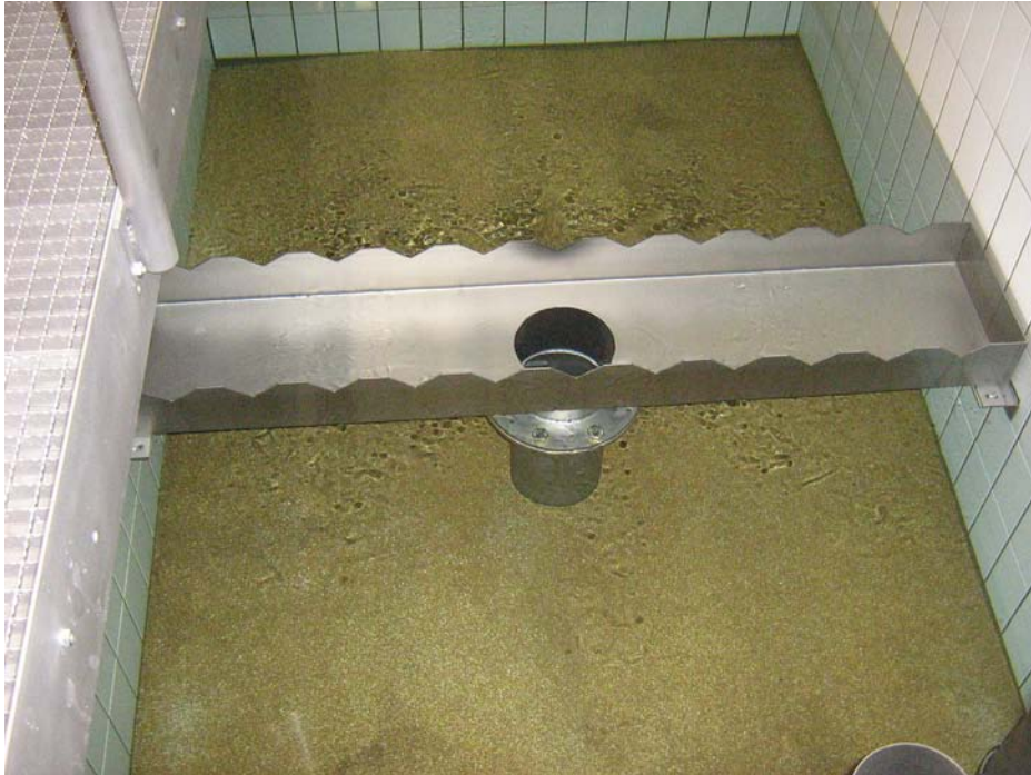
Abb. 12: Entsäuerungsanlage mit offenem Filterbecken
