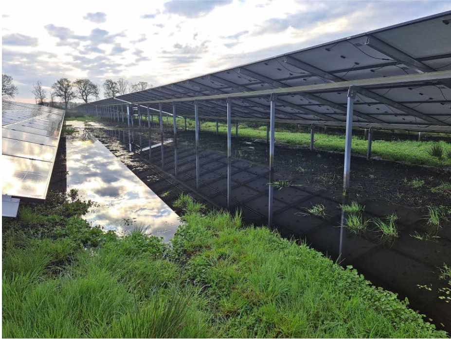
Abb. 29: Überstaute Modulflächen im Nordteil der PV-Anlage am 26.04.2023
