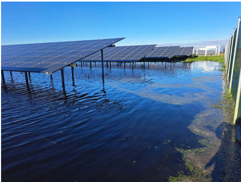
Abb. 44: Am 23.11.2023 großflächig überstaute Modulflächen im östlichen Randbereich des Südteils der PV-Anlage
