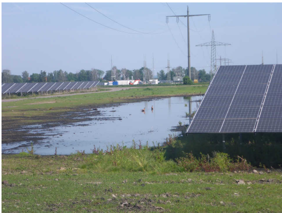
Abb. 38: Überstaute Brach- und Ruderalfläche im Nordteil der PV-Anlage mit Nachweisen unter anderem von Rostgans und Graureiher
