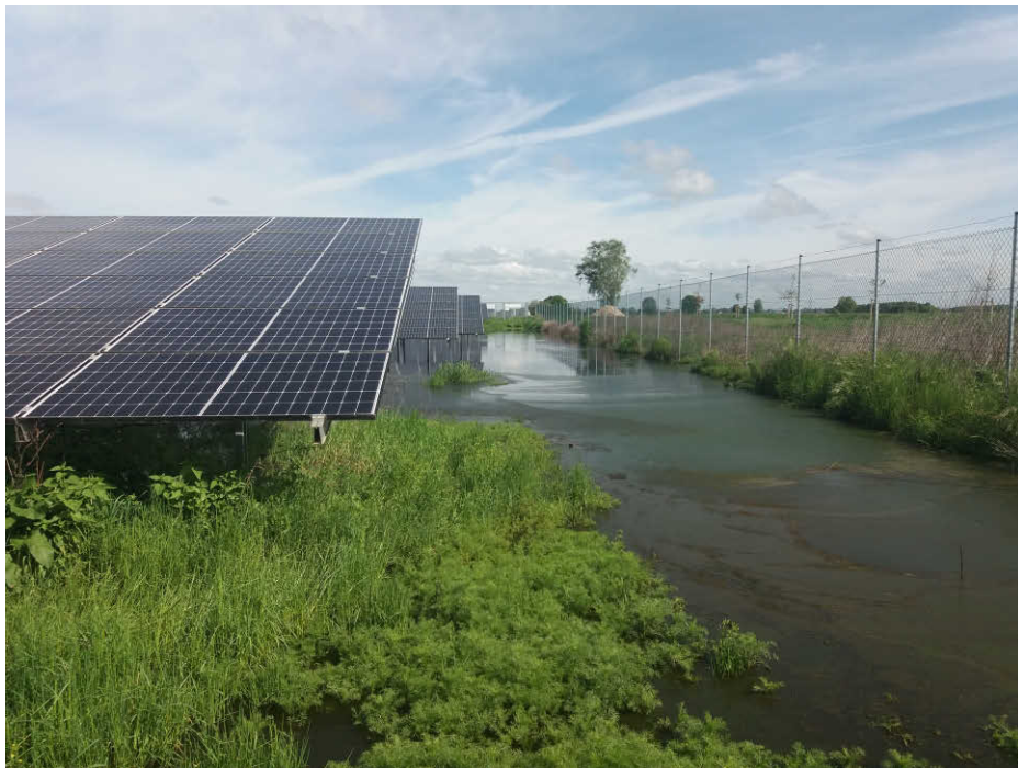
Abb. 41: Am 17.05.2023 groß- flächig überstaute Mo- dulflächen im östlichen Randbereich des Süd- teils der PV-Anlage
