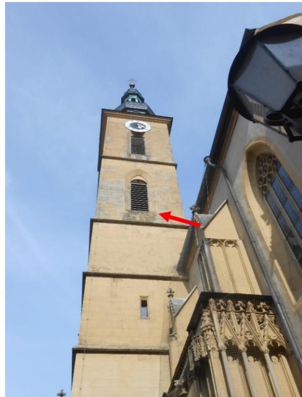
Abb. 49: Als Tagesquartier genutzter Kirchturm der Stadtkirche St. Johannes (offenbar in einer Fuge in der Außenwand) in der Altstadt Kitzingens Anfang Mai 2019
