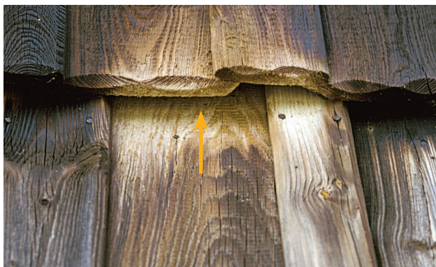
Abb. 11 (links): Die braune Verfärbung des Balkens wird durch Körperfett verursacht und ist typisch für Männchenquartiere des Mausohrs.
