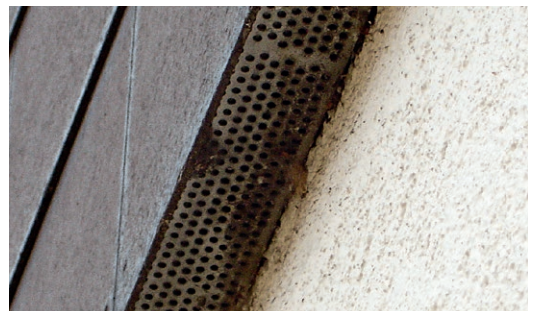
Abb. 27: Insektengitter an einem Flachdachabschluss.
