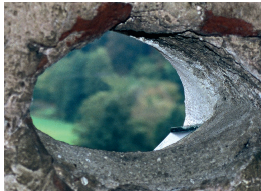
Abb. 46, 47: An diesem Kirchturm wurden die vor zehn Jahren vorsorglich gegen Tauben angebrachten Vergitterungen an den Eulenlöchern wieder entfernt. Verwilderte Stadtauben gibt es in dieser Ortschaft nicht.
