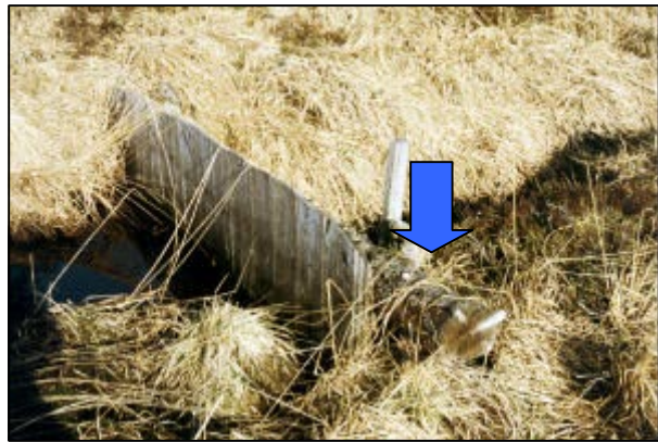
Foto 41. Stauwehr aus Nut- und Federbrettern (manuell eingebaut mit manueller Torfhinterfüllung): SW hält dem Wasserdruck seitlich nicht stand; Nut- und Federbretter werden auseinander gebogen (Pfeil).
