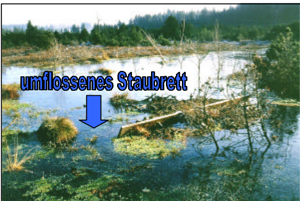
Foto 44. Bretterwehr (mit Kleinbagger eingebaut) mit zu geringer Anstaubreite – daher von unterhalb liegendem Stauwehr mit Holzunterbau (mit Moorbagger eingebaut) „überstaut“. Altenbergfilz bei Dietramszell, Lkrs. Bad Tölz-Wolfratshausen. 1/2002.
