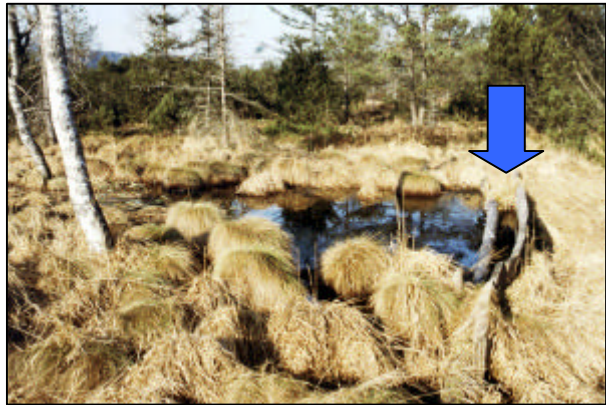
Foto 43. dto. seitliche Aufnahme. Verformung des Stauwehrs in Richtung Unterwasser. Fotos 41-43 Mühleckerfilze, Lkrs. Weilheim-Schongau; 1/2002.
