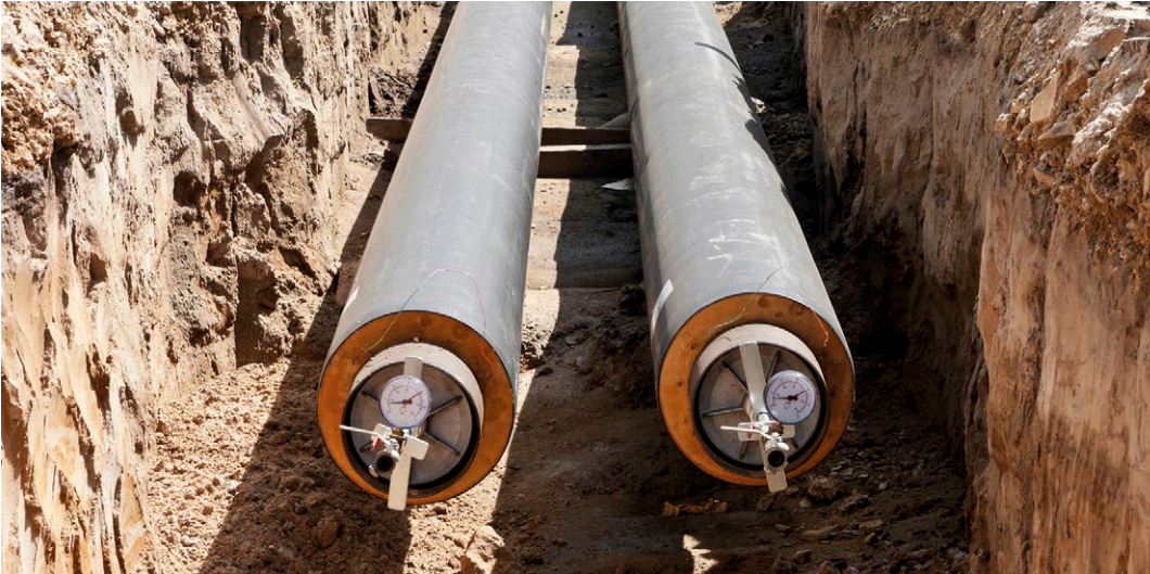
Die Leitungsquerschnitte sollten Sie möglichst klein und die Dämmung möglichst stark dimensionieren.
