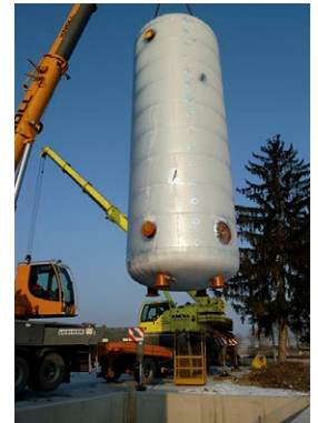
Konventionelle Wärmespeicher decken Bedarfsspitzen ab. Dadurch können die Rohrleitungen kleiner dimensioniert werden.
