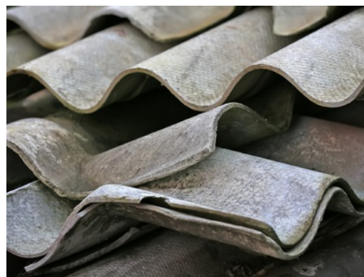
Abb. 12: Verschenken von asbesthaltigen Bauteilen ist verboten.
