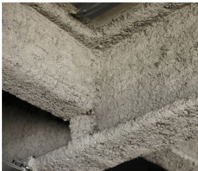
Abb. 3: Weltweit findet man Asbest noch als Spritzasbest, ...
