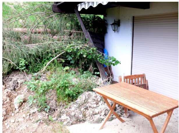
Abb. 25: Auch Hanganbrüche mit kleinem Volumen können große Schäden verursachen, wie nach Starkregen im Jahr 2013 in Sachrang (Lkr. Rosenheim). GEORISK Nr. 8339GR015001
