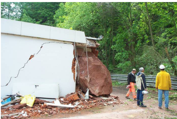
Abb. 8: Im Jahr 2005 zerstörte ein kleiner Felssturz bei Miltenberg ein Gebäude. GEORISK Nr. 6221GR015001
