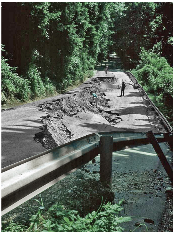
Abb. 5: Tiefreichende Rutschungen verursachen wiederkehrende Straßenschäden.
