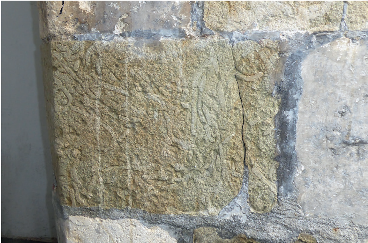
Abb. 31: Mauerstein mit Wurm Spuren, Stadtturm in Straubing.
