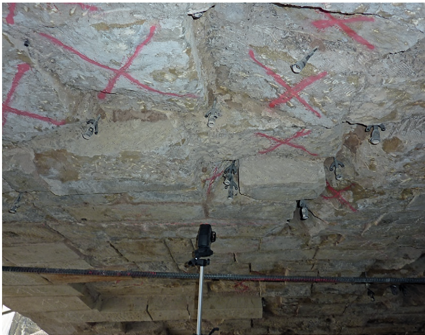
Abb. 2: Unterer Teil eines Bogens der Steinernen Brücke. Die auszu- tauschenden Blöcke sind mit roten Kreuzen markiert.
