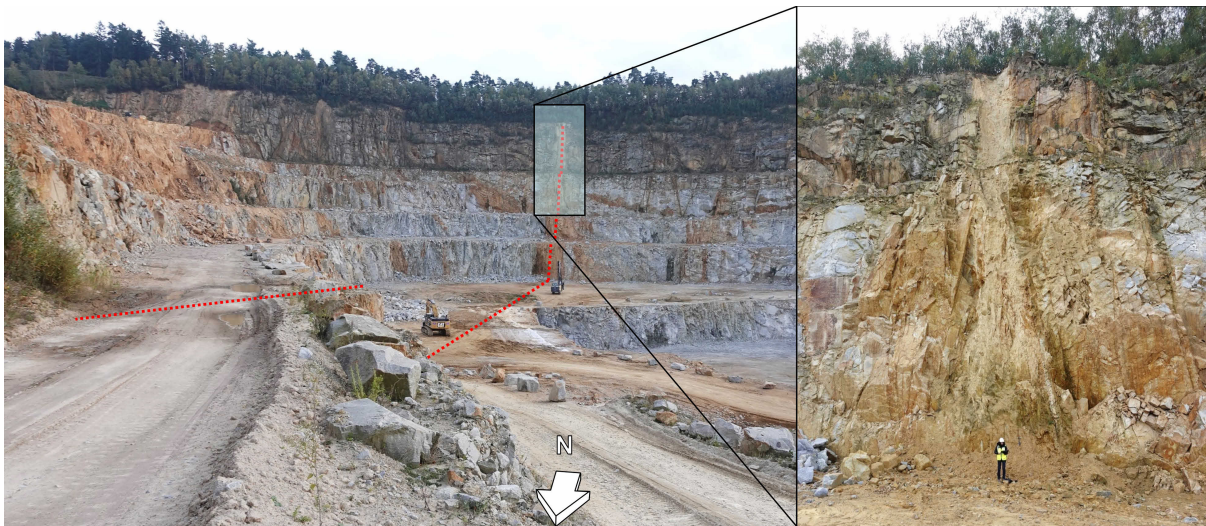
Abb. 4: Ansicht des Steinbruchs Blauberg mit N-S bis NNE-SSW streichender Hauptstruktur. Die Störung mit wahrscheinlich abschiebender und/oder sinistraler Kinematik ist gekennzeichnet durch eine bis zu mehreren Metern mächtige Zerrüttungszone mit Ton-Letten und Quarz-Gängen. Letztere wurden teilweise durch jüngere Bewegungen kataklastisch zerbrochen (siehe auch Abb. 6e).
