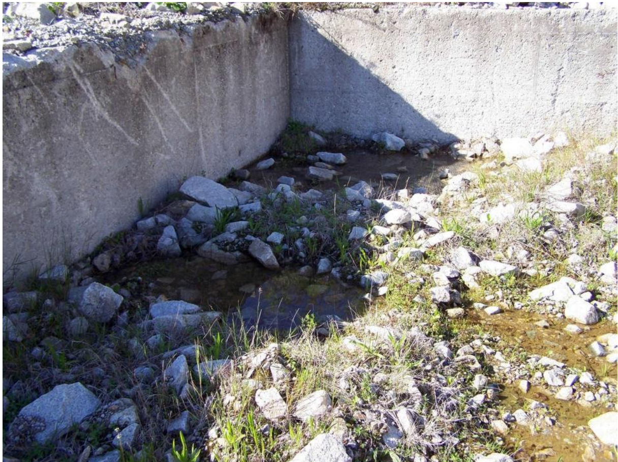
Foto 6: Pfütze in Betonbecken
