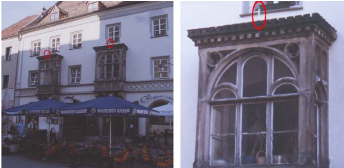
Abb. 7.12: Zwei Mobilfunkantennen für Mikrozellenversorgung, montiert an einer Gebäudefassade. In den dahinter liegenden Räumen muss mit überdurchschnittlich hohen Feldern gerechnet werden.
