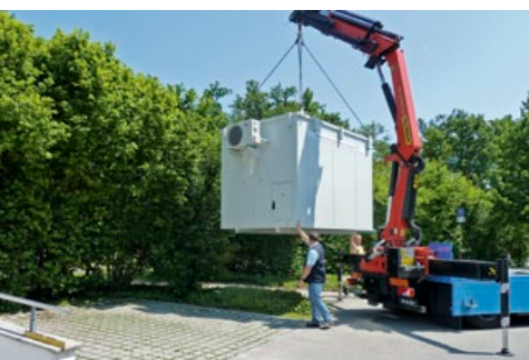
Bilder o. + r.: Der Messcontainer wird im Kurpark in Bad Füssing aufgestellt.
