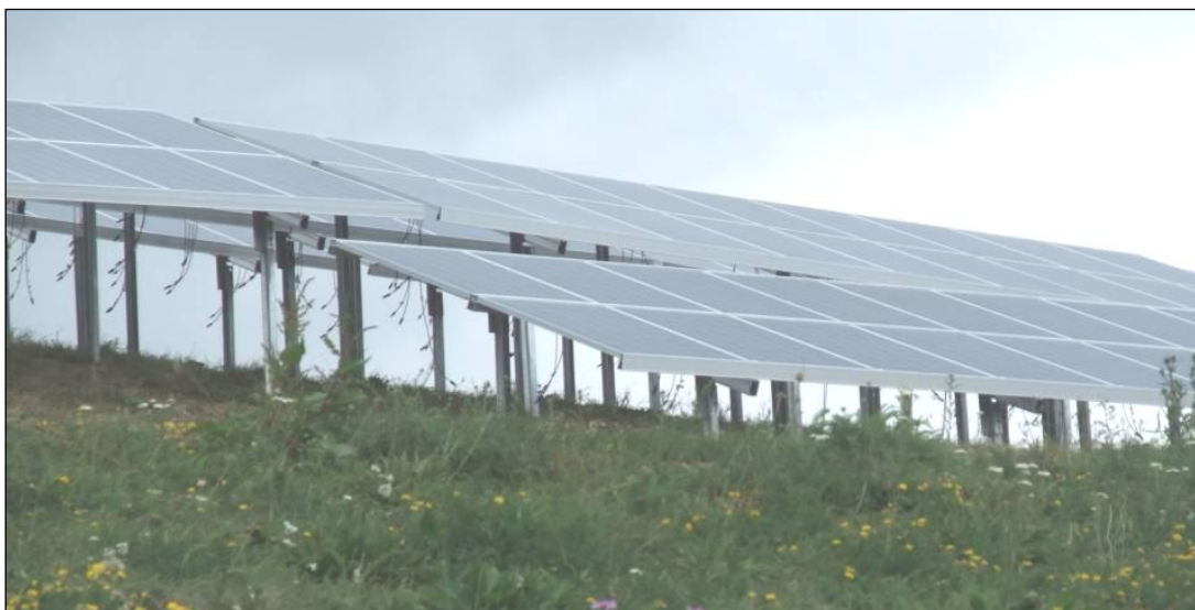
Abb. 2: Beispiel einer PVA mit Rammfundamenten
