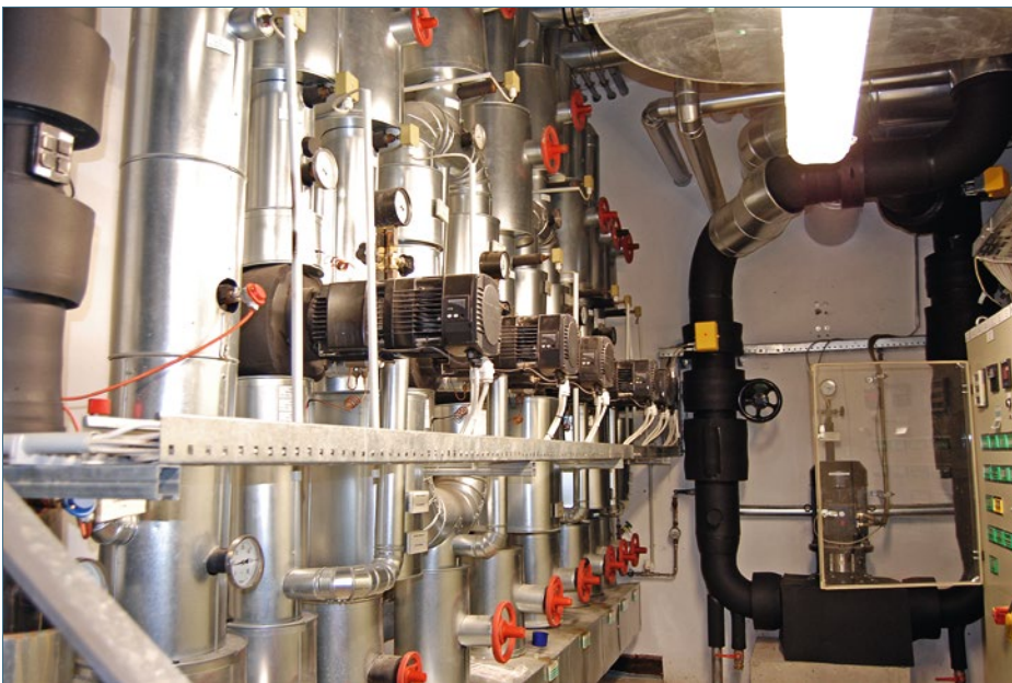
Abb. 6: Hochdruckleitungen der Kälteanlage aus Standort Augsburg
