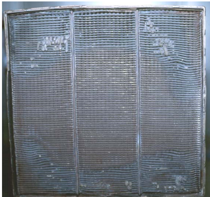
Abbildung 45: Rußfiltereinsatz des BHKW Weißenburg mit Schmelzablagerungen in den Randbereichen
