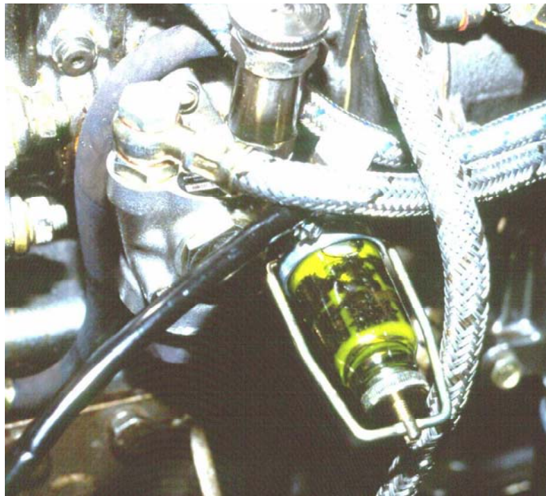
Abbildung 47: Flockenförmige Ablagerungen im Kraftstoffvorfilter vor der mechanischen Kraftstoffförderpumpe am BHKW Greußenheim
