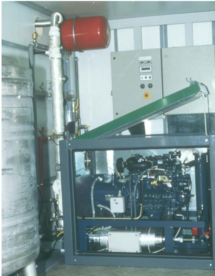
Abbildung 12: BHKW der Landtechnik Weihenstephan mit Tagestank (Vordergrund) Abgasrohr und Schaltschrank
