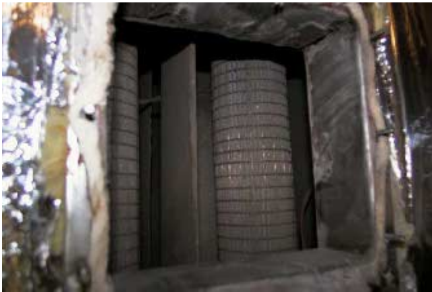
Bild 7.1-1: Blick auf Filterelemente durch Revisionsöffnung
