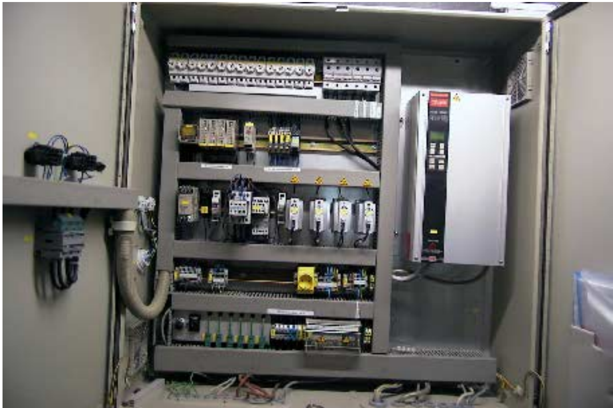
Bild 4.2-3: Schaltschrank in angeschlossenem Zustand an der Versuchsanlage (Innen)
