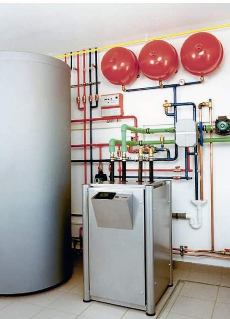
Wärmepumpe mit Speicher
